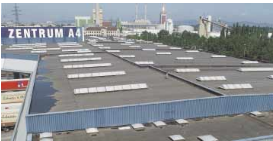
Die Auffindung von Dachschäden ist auch auf großen Industrie-Dachflächen kein Problem
