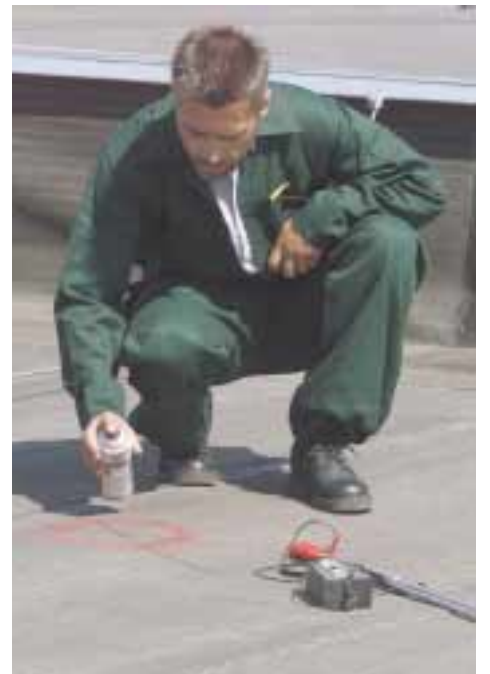
Erster Schritt: Die Kennzeichnung von undichten Stellen
